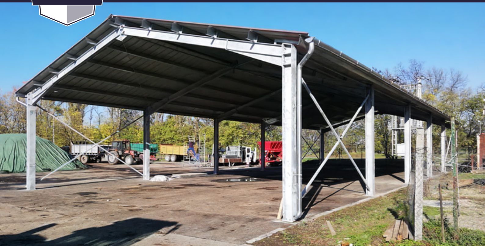
Hangar cu laturi deschise 12 m x 30 m x 4 m | Locul constructiei: Dunaharaszti
